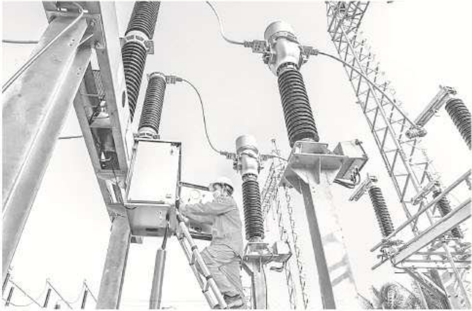
Tính xác định công nghiệp và năng lượng là động lực quan trọng để thực hiện mục tiêu tăng trưởng nhanh, bền vững. Trong ảnh: Vận hành Trạm biến áp 110kV Thanh Tân, xã Tân Thành Bình. Ảnh: CẨM TRÚC
