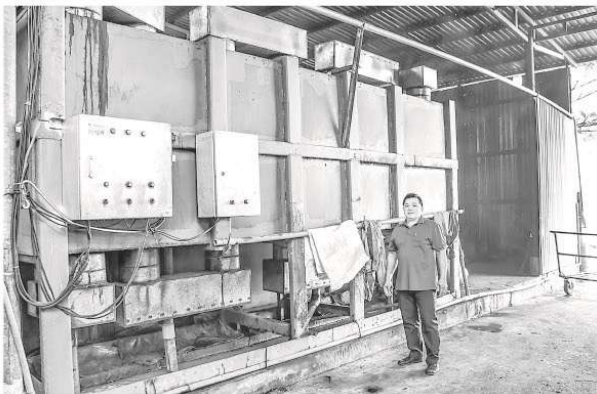
Hệ thống thu gom, xử lý khói thải tại Cơ sở sản xuất than thiêu kết Thông Quí Thuận, ấp Quí Điền.
