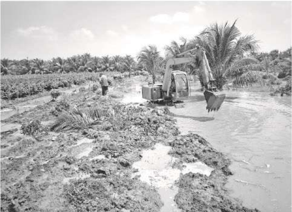
Xã Chợ Lách đã triển khai xử lý khẩn cấp tại vị trí sạt lở. Ảnh: CẨM TRÚC
