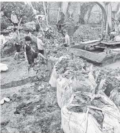
Khắc phục tạm thời đoạn sạt lở đê bao ấp Phước Lý Nhất.
