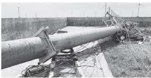
Trụ 1 bị gãy đổ hiện trường.
